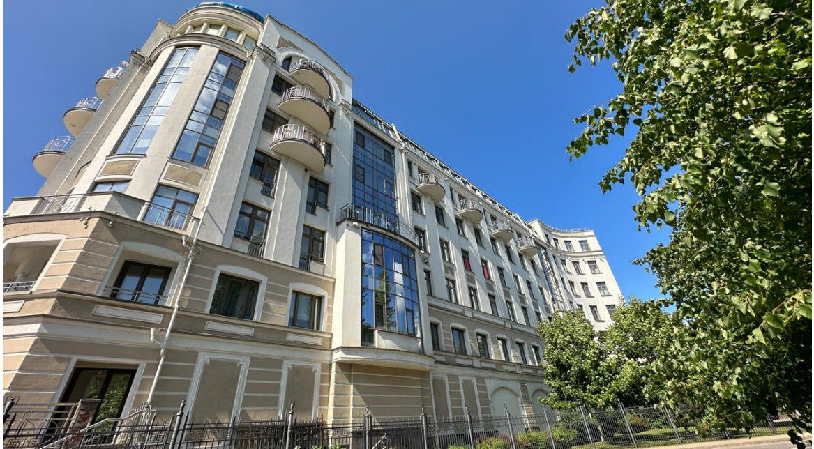
Фото 10. Общий вид условной части №5 восточной стороны фасада здания и дефекты в виде растрескивания штукатурки и окраски на фасаде, откосах и балконах
